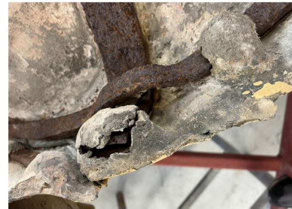
Smidesskelettet var sammanfogat med blypuckar. Korrosion har gjort att flera av dessa brustit.
