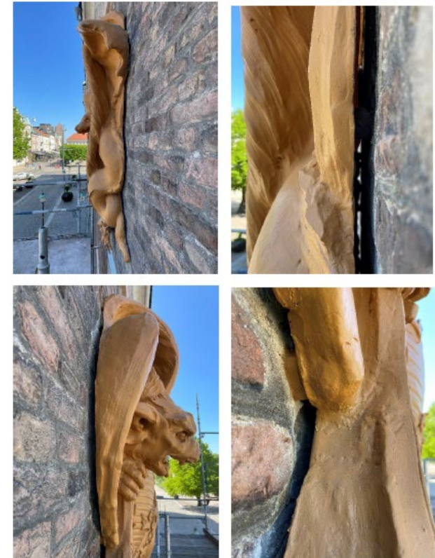
Kartuschen är monterad så nära murverket det var möjligt, vilket innebar med något större distans än tidigare.
