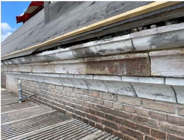
Gipsstenen har lagts med gipsbruk. Svårt sargade ytor har i princip spacklats över hela ytan.
