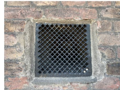
Renoverat ventilgaller i plan 1 eller 2. Fogen har patinerats.
